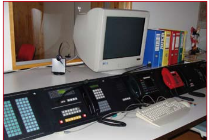
BAWZ mit Sirenensteuergerät, Funkplätzen und Notruftelefonen
