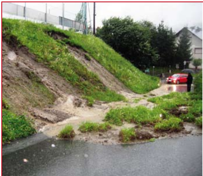
Abrutschungen bei der Gemeindesportanlage
